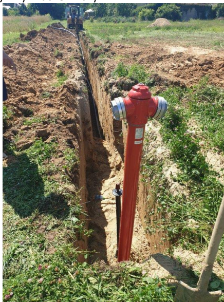
Fot.14 Sieć wodociągowa na terenie gminy Brudzeń Duży
