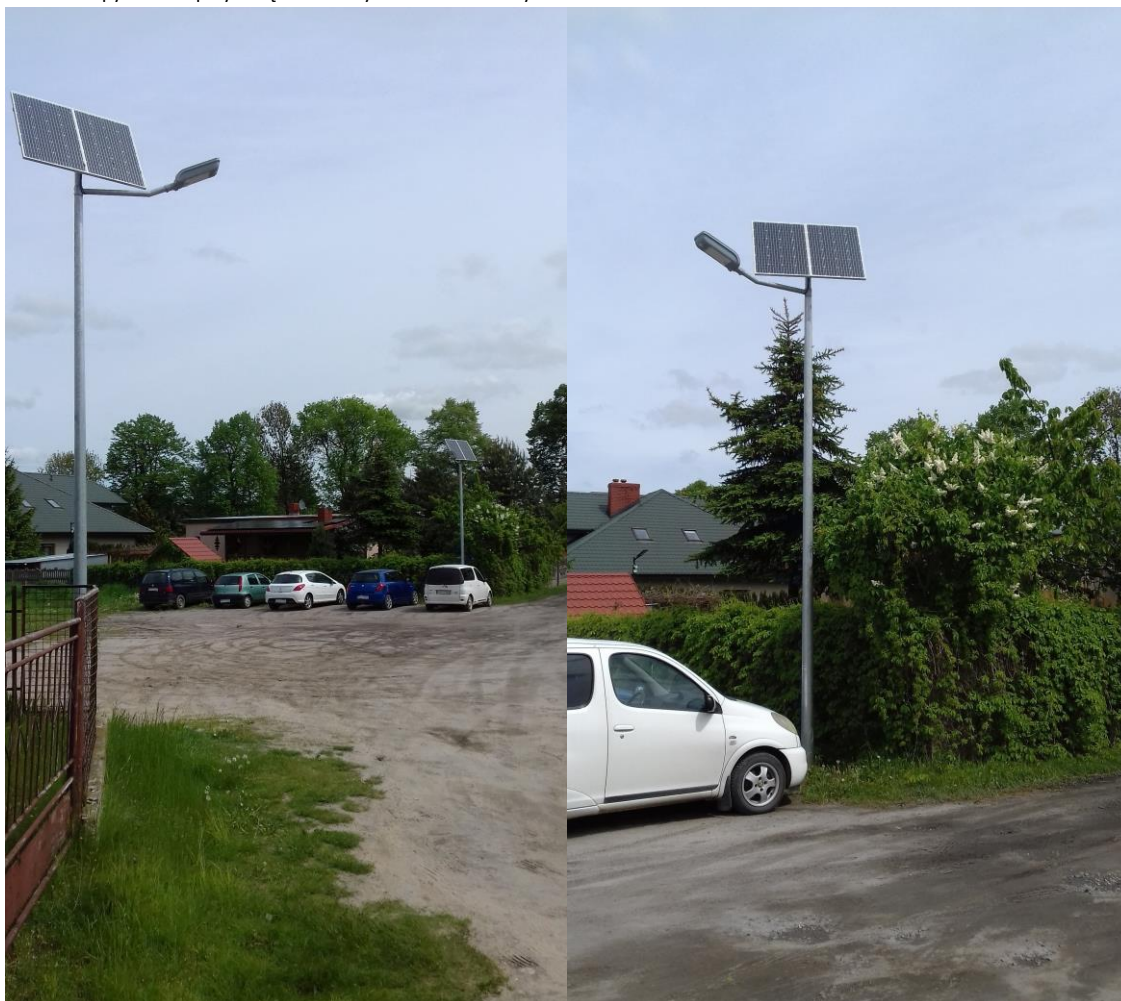
Fot.18 Lampy solarne przy Urzędzie Gminy w Brudzeniu Dużym
