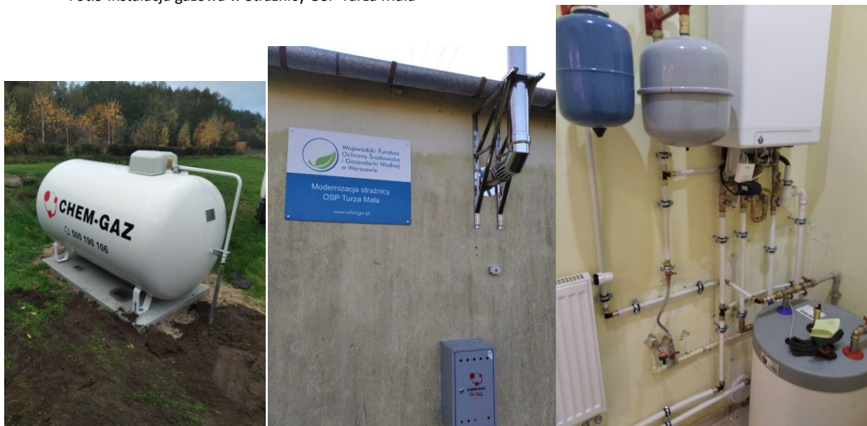
Fot.9 Instalacja gazowa w Strażnicy OSP Turza Mała
