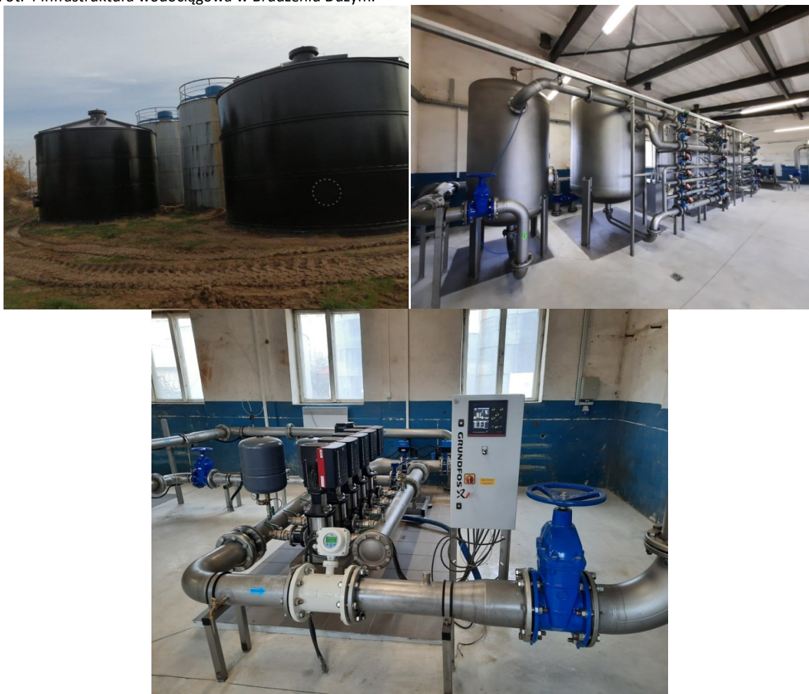
Fot. 4 Infrastruktura wodociągowa w Brudzeniu Dużym.
