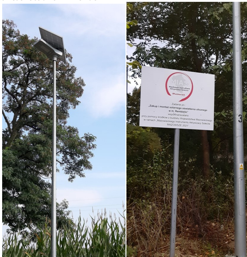
Fot. 14 Oświetlenie solarne w m. Rembielin
