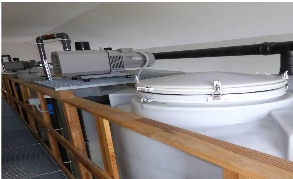
Fot. nr 8. Widok reaktorów cyklicznych SBR o pojemności po 15 m 3 każdy w oczyszczalni ścieków w Siecieniu
