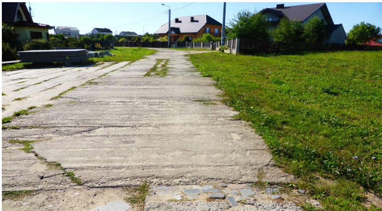
Fot. nr 79. Widok płyt drogowych żelbetowych na drodze gruntowej w Brudzeniu Dużym pod którą prawdopodobnie są studnie kanalizacji sanitarnej
