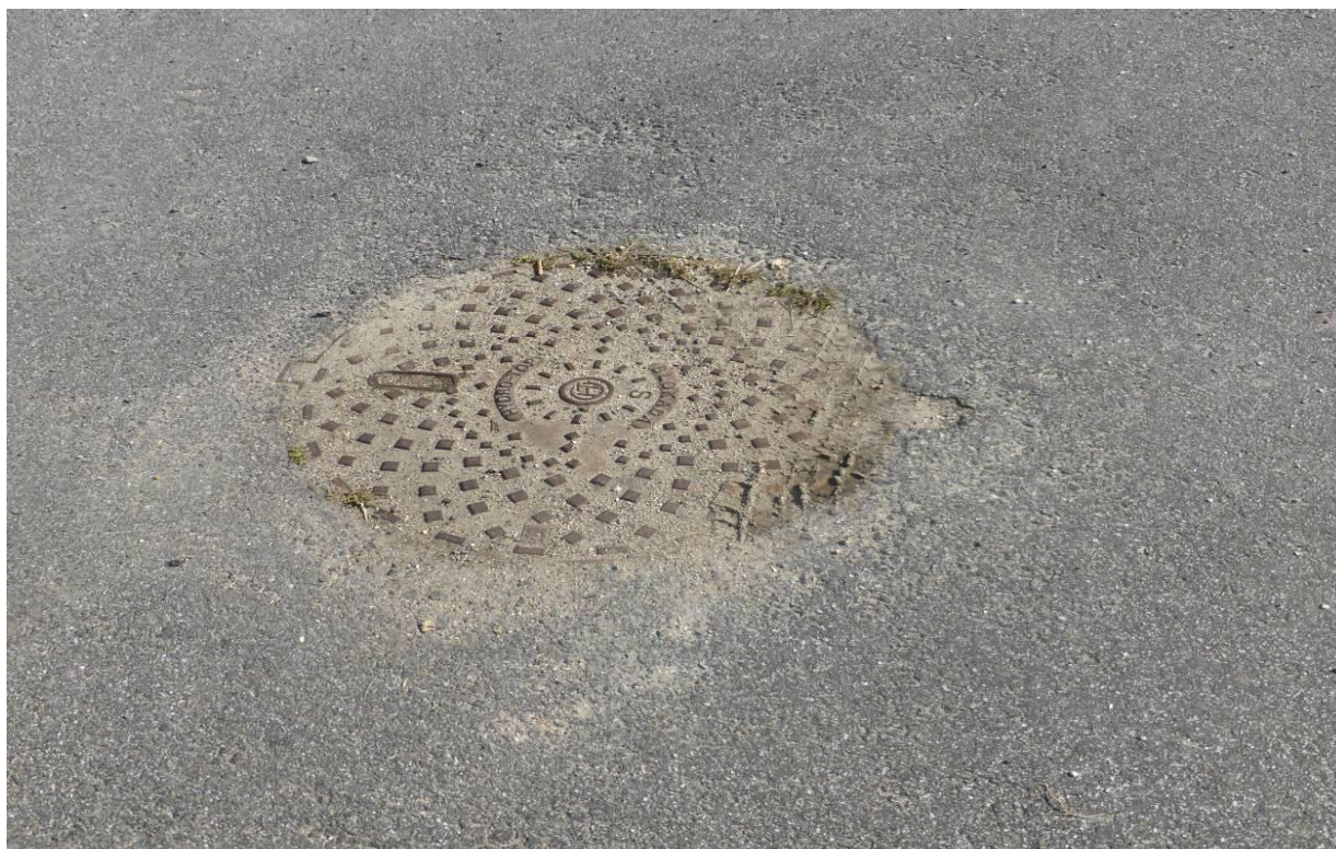
Fot. nr 89. Studnia kanalizacyjna w drodze gruntowej w Brudzeniu Dużym – asfalt uniemożliwia otwarcie studni
