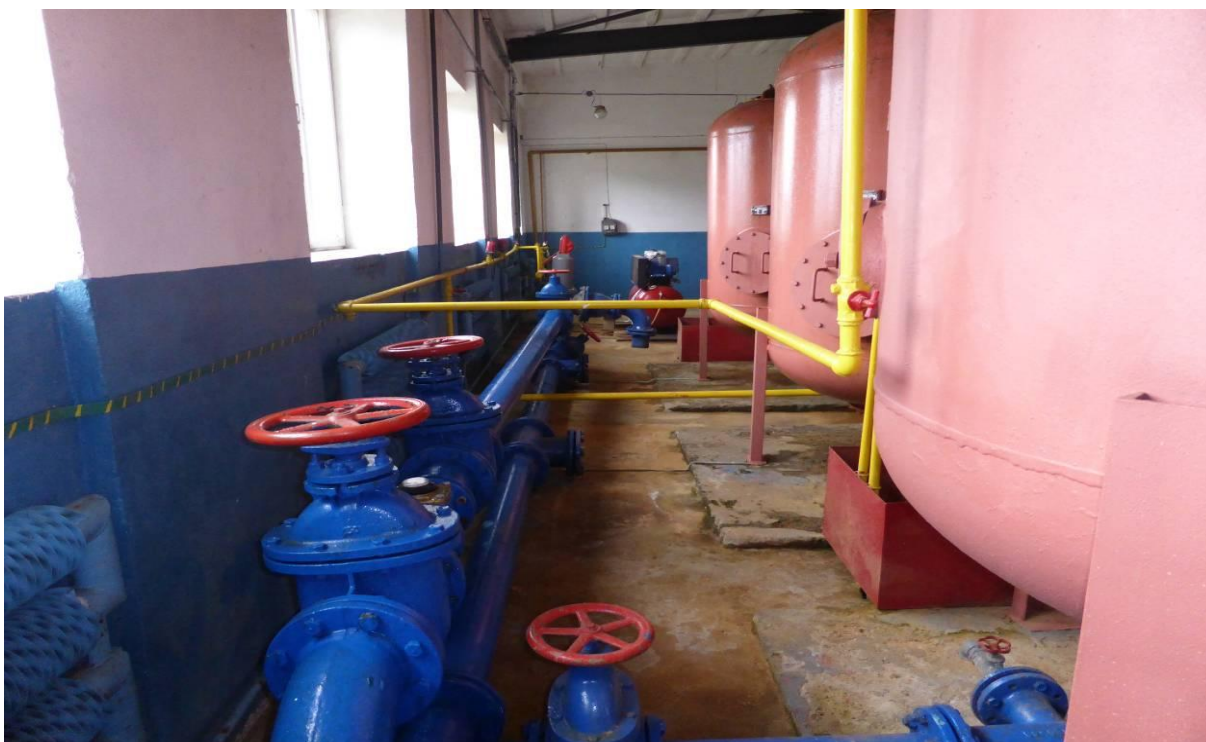
Fot. nr 20. Widok pomieszczenia z urządzeniami technologicznymi stacji uzdatniania wody w Brudzeniu Dużym
