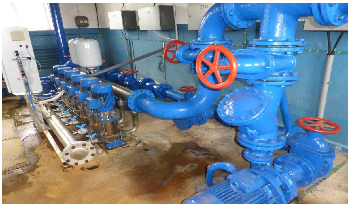
Fot. nr 22. Widok stacji pomp na stacji uzdatniania wody w Brudzeniu Dużym
