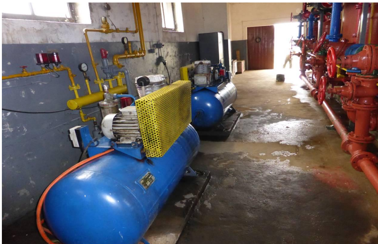
Fot. nr 33. Widok pomieszczenia z urządzeniami technologicznymi stacji uzdatniania wody w Karwosiekach – inne ujęcie
