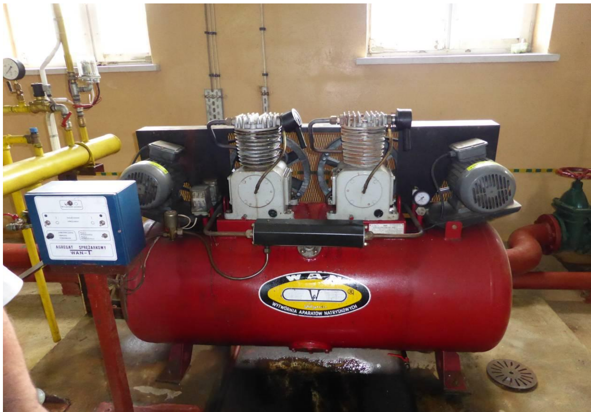
Fot. nr 5. Widok sprężarki stacji uzdatniania wody w Siecieniu
