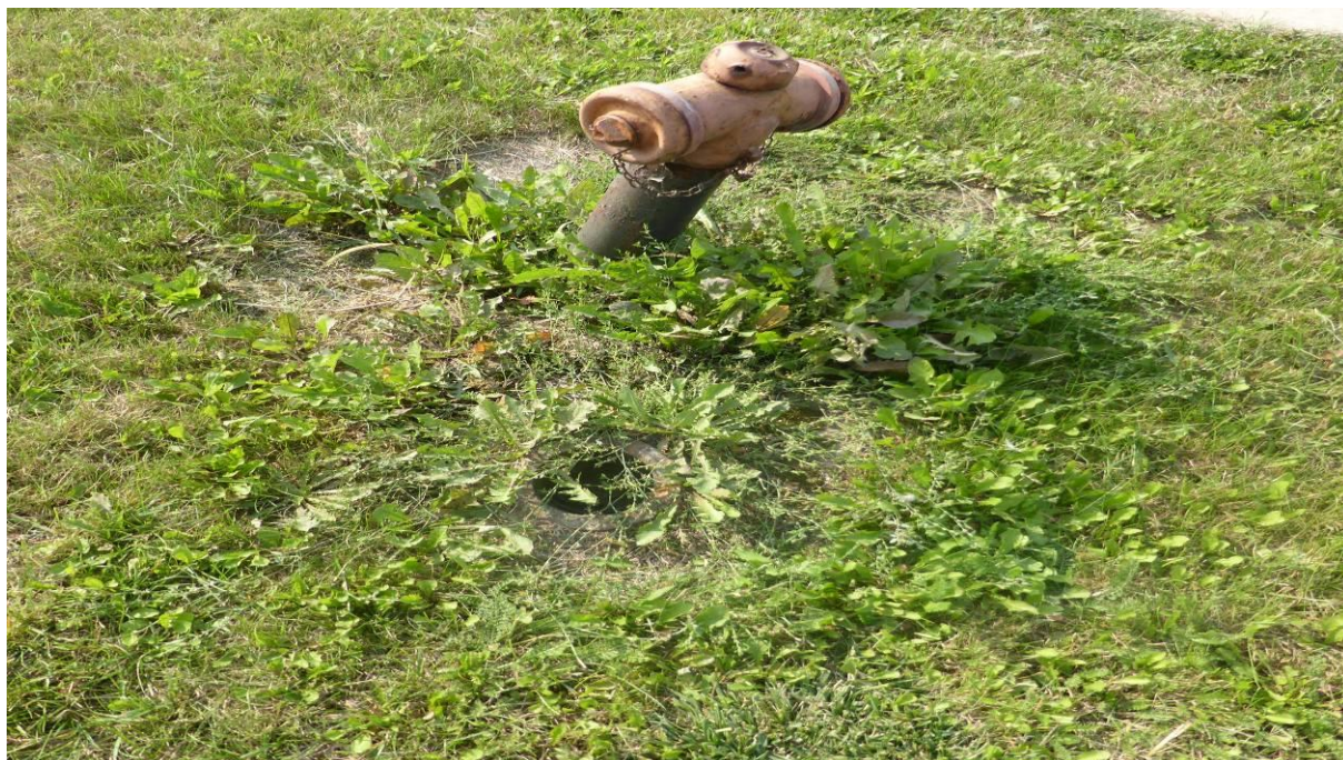
Fot. nr 48. Widok hydrantu ppoż. w Siecieniu
