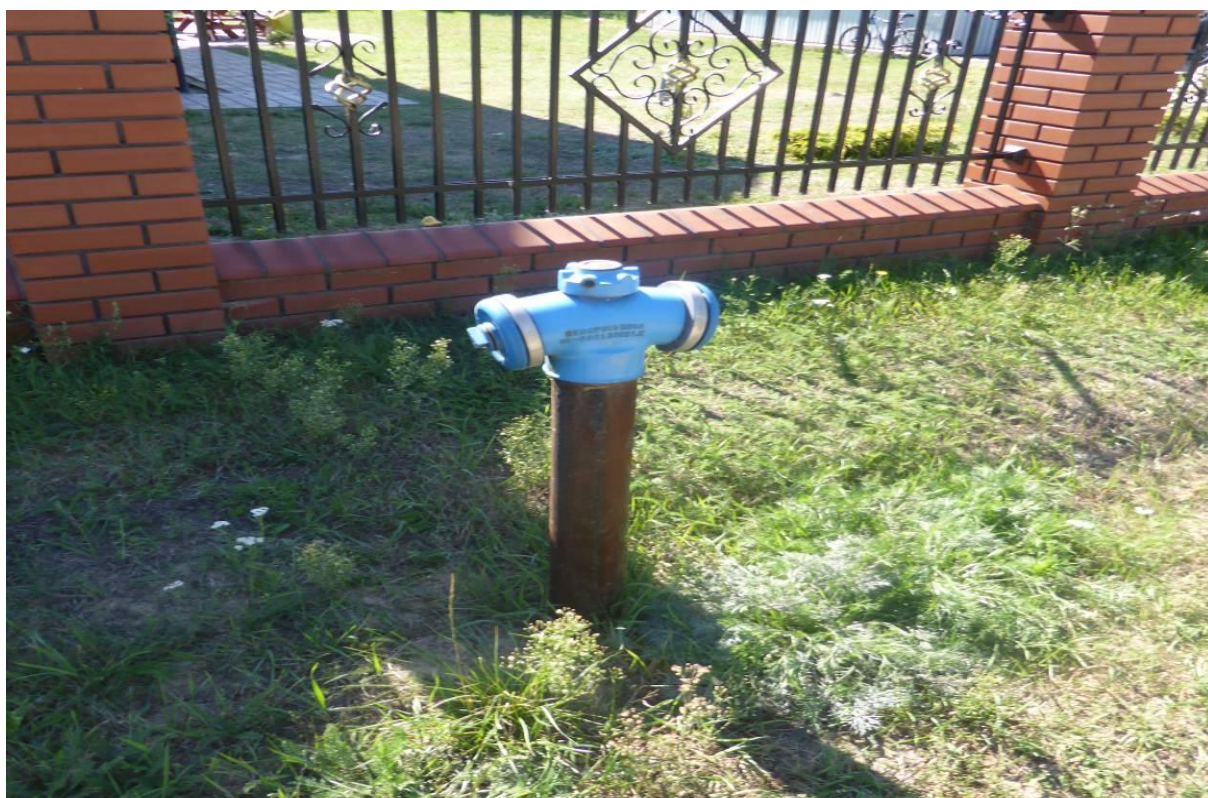
Fot. nr 61. Hydrant w Brudzeniu Dużym
