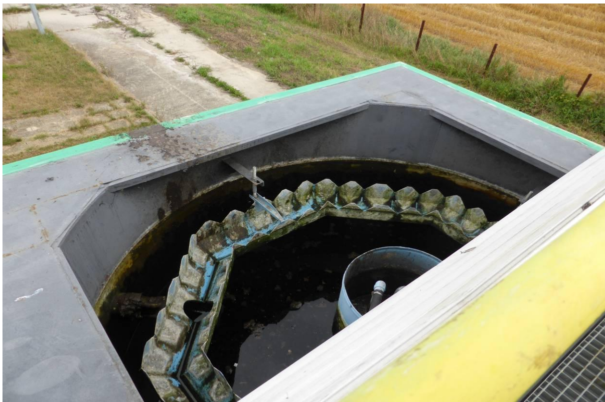
Fot. nr 28. Osadnik wtórny oczyszczalni ścieków typu BIOBLOK w Brudzeniu Dużym
