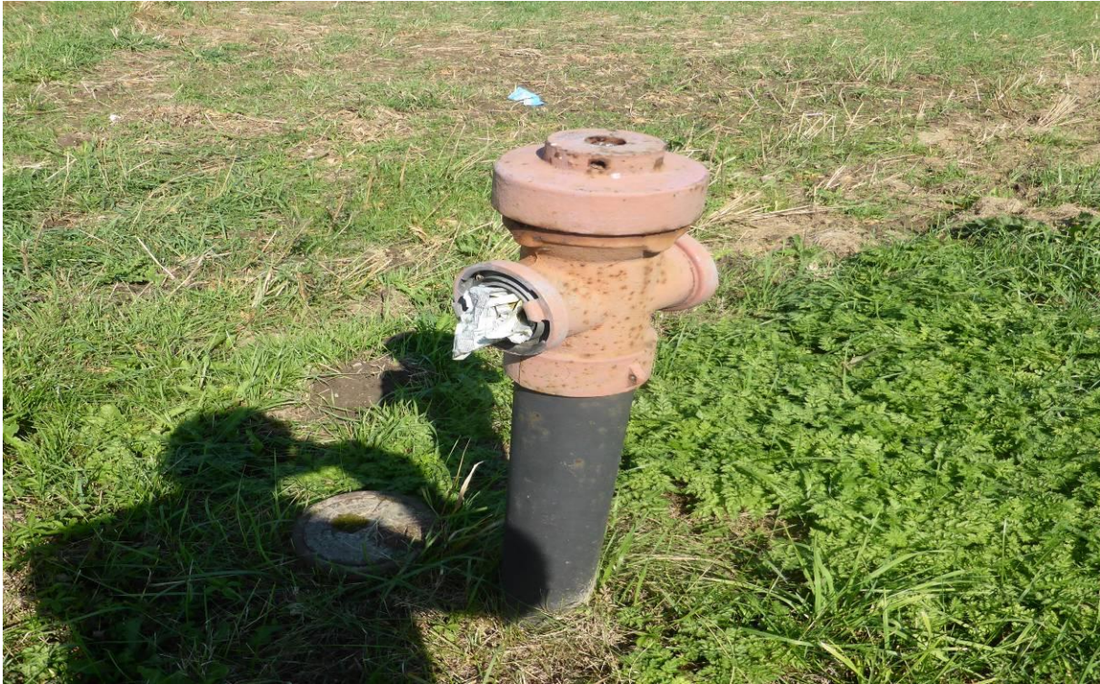
Fot. nr 70. Hydrant w Brudzeniu Dużym
