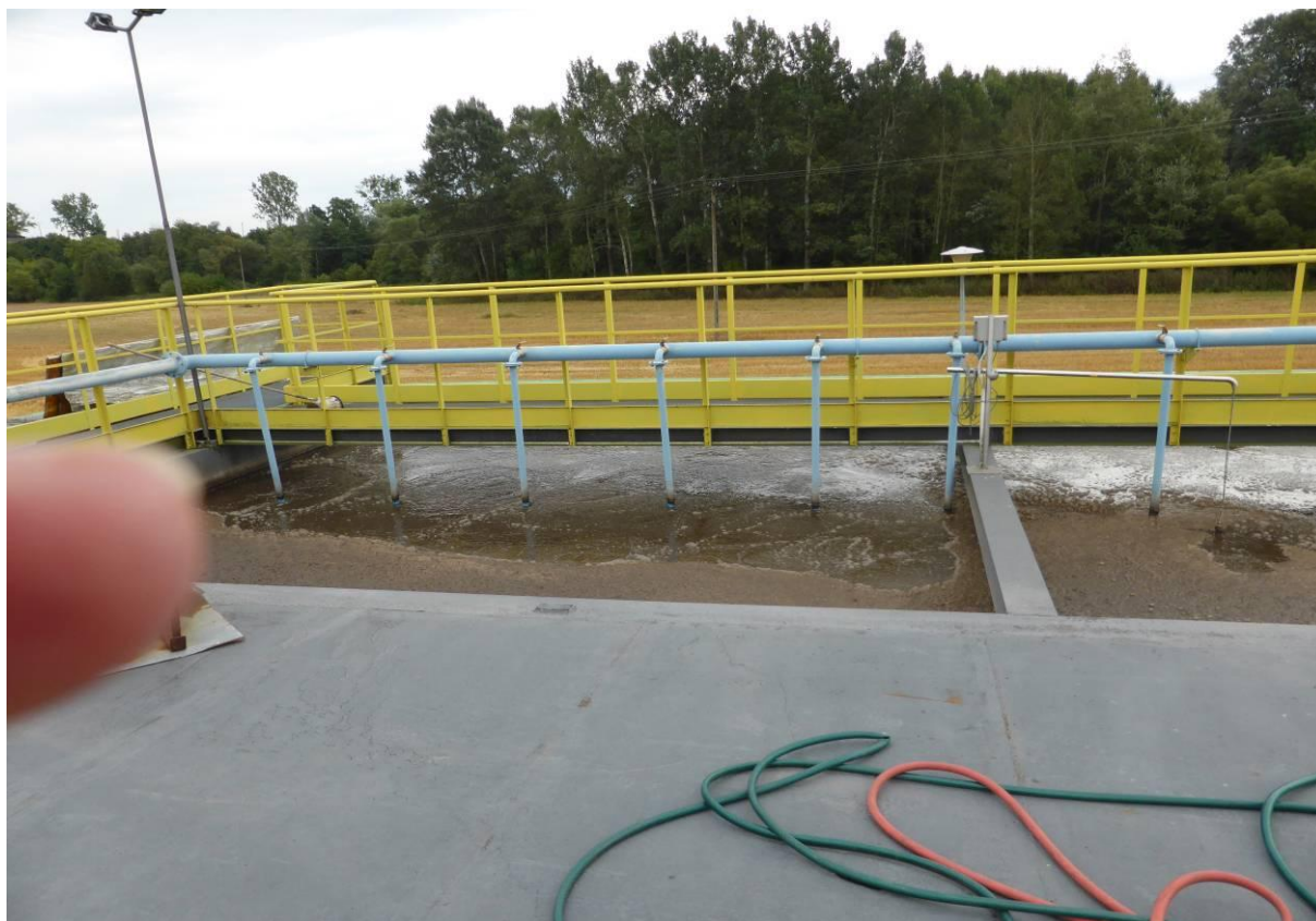
Fot. nr 26. Komory osadu czynnego oczyszczalni ścieków typu BIOBLOK w Brudzeniu Dużym
