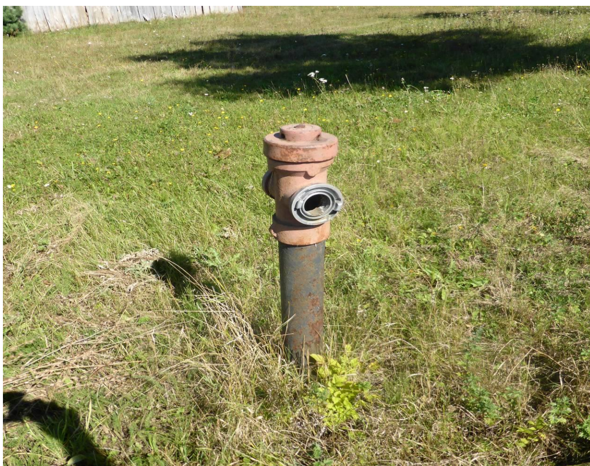
Fot. nr 51. Widok hydrantu ppoż. w Karwosiekach Noskowice - niesprawny
