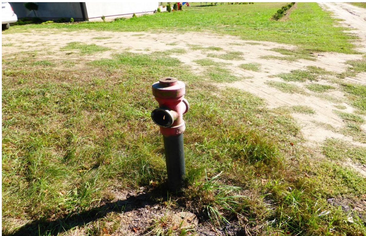
Fot. nr 62. Hydrant w Brudzeniu Dużym
