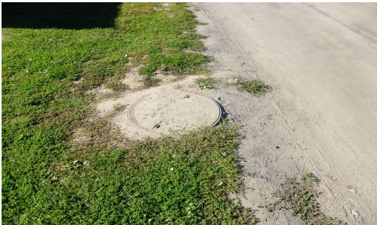
Fot. nr 77. Studnia kanalizacyjna przy drodze gruntowej w Brudzeniu Dużym
