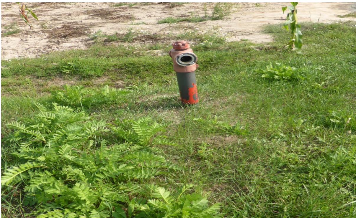
Fot. nr 47. Widok hydrantu ppoż. w Siecieniu
