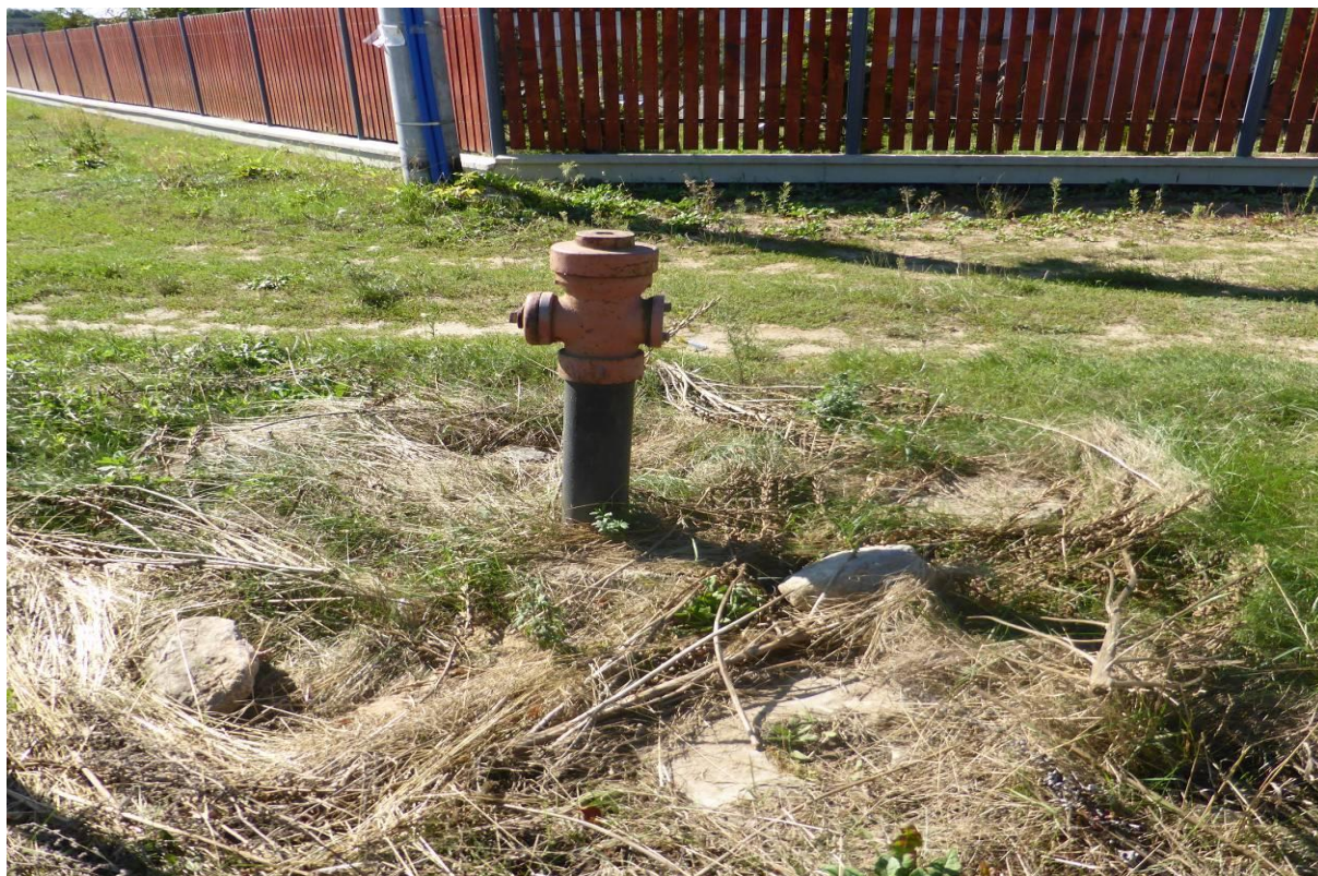
Fot. nr 60. Hydrant w Brudzeniu Dużym
