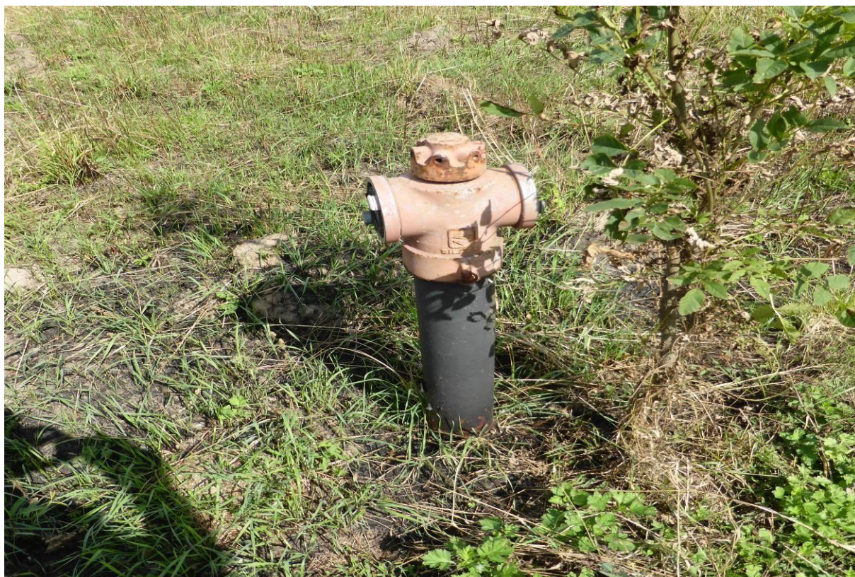
Fot. nr 39. Widok hydrantu ppoż. w Parzeniu
