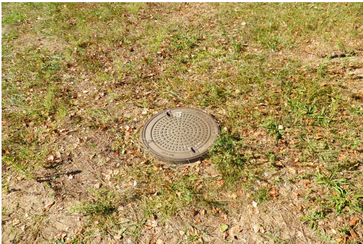
Fot. nr 75. Studnia kanalizacyjna na działce prywatnej w Brudzeniu Dużym
