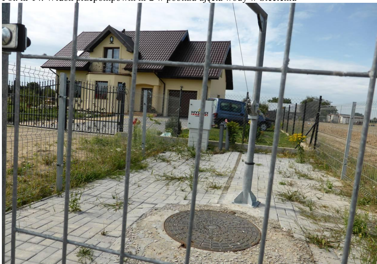
Fot. nr 15. Widok przepompowni nr 1 w Siecieniu
