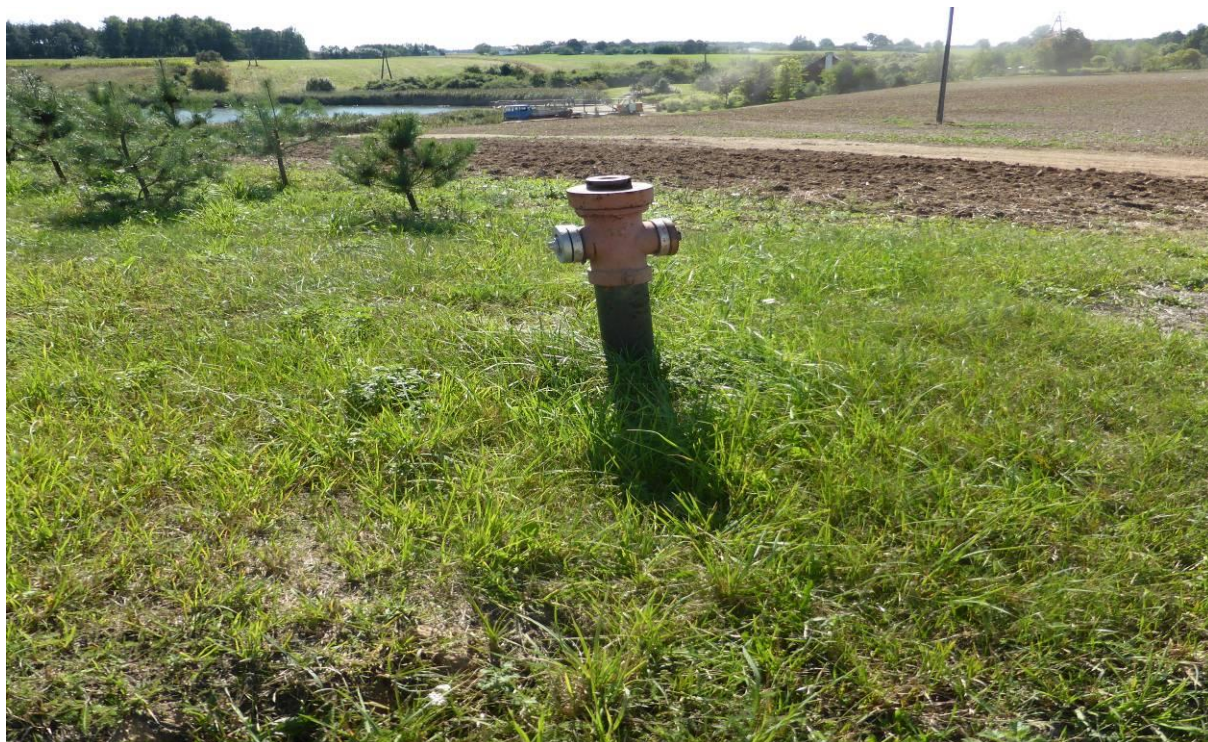
Fot. nr 50. Widok hydrantu ppoż. przy stacji uzdatniania wody w Karwosiekach
