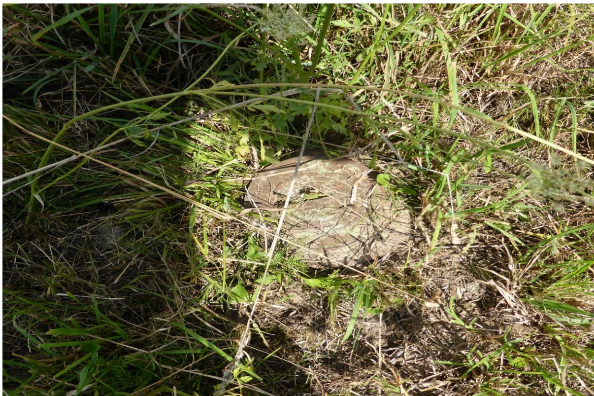
Fot. nr 41. Widok skrzynki ulicznej do zasuw w Parzeniu – brak jest betonowego korytka stabilizującego
