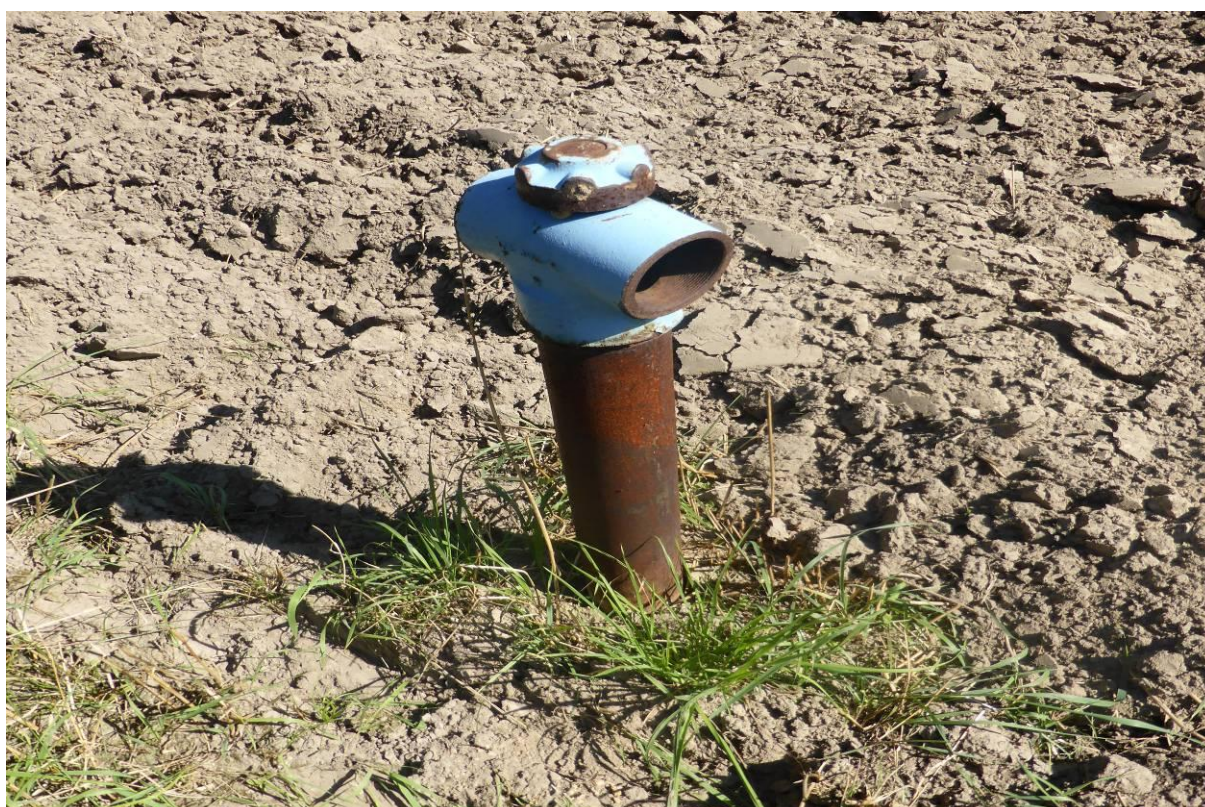
Fot. nr 55. Uszkodzony hydrant w Janoszycach - niesprawny
