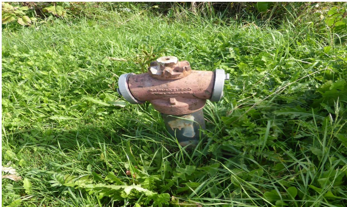
Fot. nr 66. Hydrant w Siecieniu
