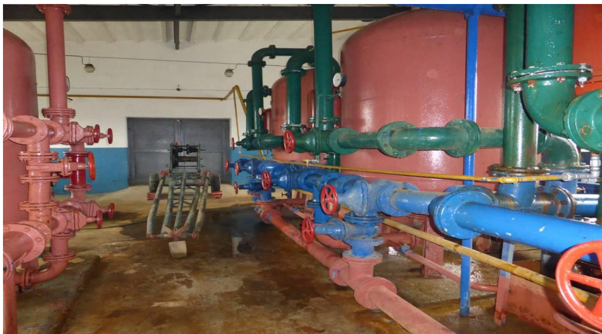
Fot. nr 18. Widok pomieszczenia z urządzeniami technologicznymi stacji uzdatniania wody w Brudzeniu Dużym
