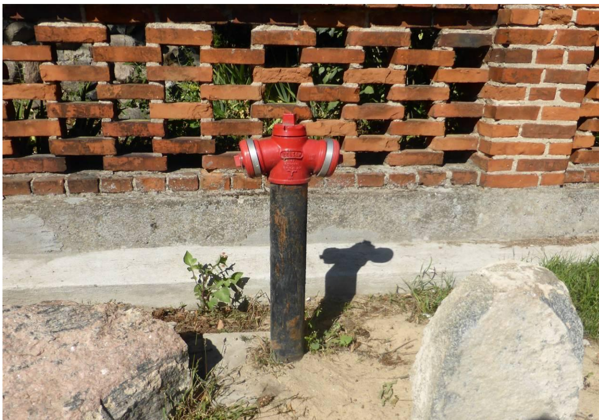
Fot. nr 58. Hydrant w Bądkowie przy kościele
