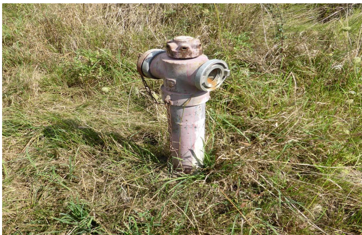
Fot. nr 40. Widok kolejnego hydrantu ppoż. w Parzeniu
