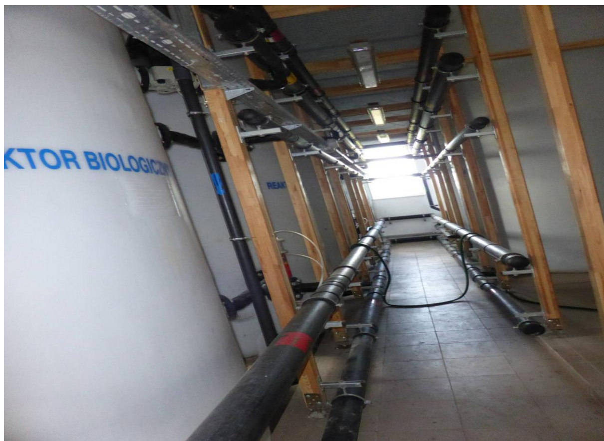
Fot. nr 9. Widok reaktorów cyklicznych SBR o pojemności po 15 m 3 każdy w oczyszczalni ścieków w Siecieniu
