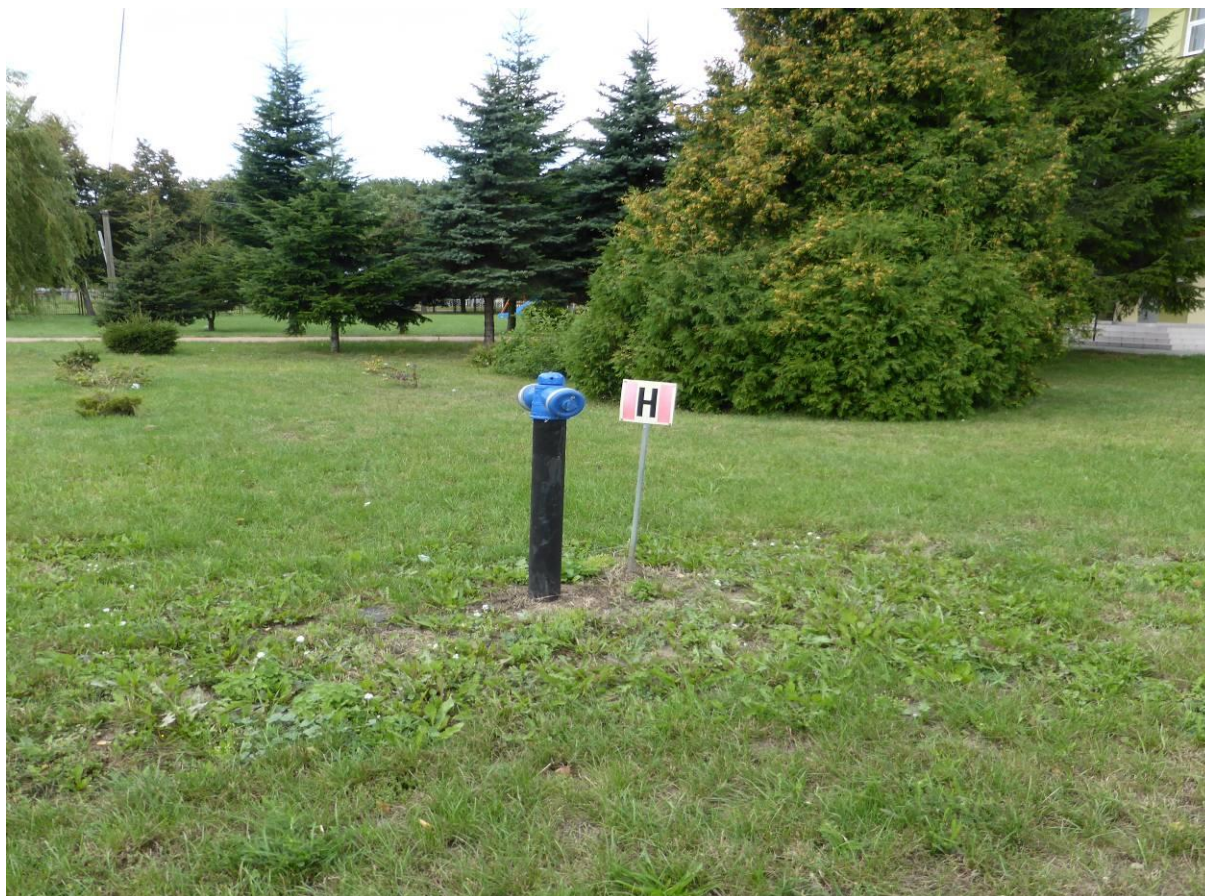
Fot. nr 36. Widok hydrantu ppoż. w Sikorzu przy Szkole Podstawowej
