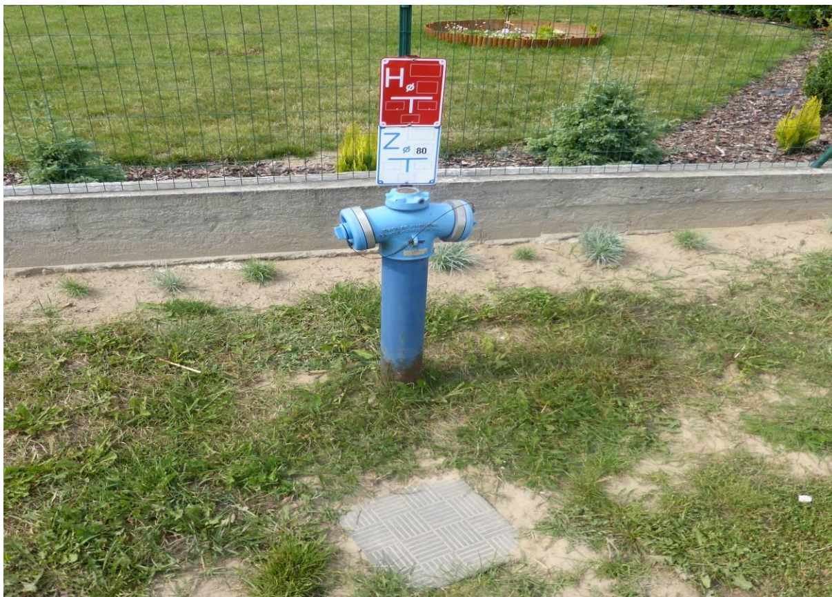
Fot. nr 46. Widok hydrantu ppoż. w Parzeniu – cztery lata od wybudowania sieci wodociągowej
