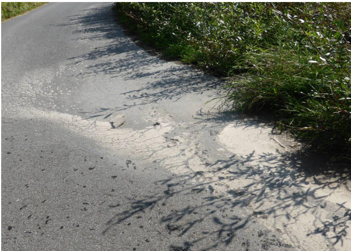
Fot. nr 91. Wyschnięte osady na drodze asfaltowej przy studni kanalizacyjnej w drodze do oczyszczalni ścieków w Siecieniu
