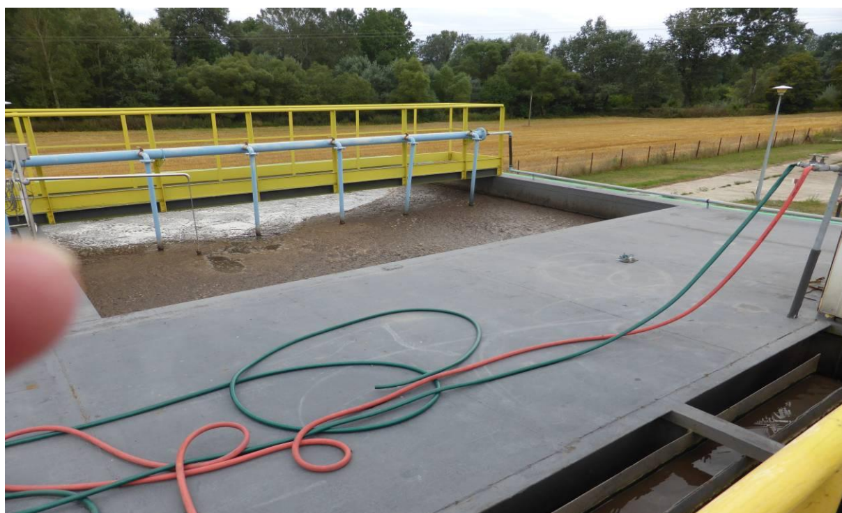
Fot. nr 27. Komory osadu czynnego oczyszczalni ścieków typu BIOBLOK w Brudzeniu Dużym
