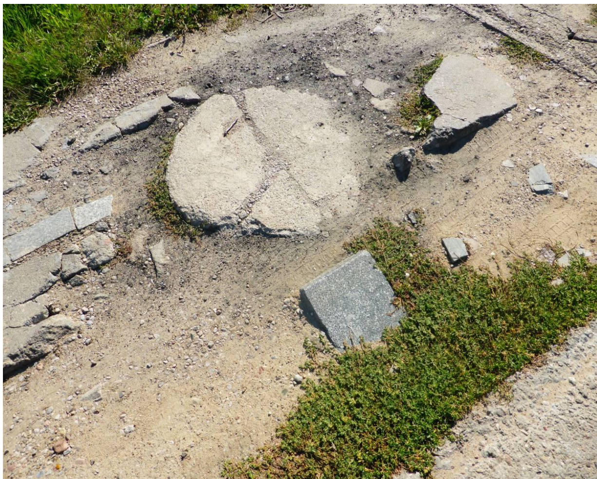
Fot. nr 78. Zniszczona pokrywa żelbetowa studni kanalizacyjnej w drodze gruntowej w Brudzeniu Dużym
