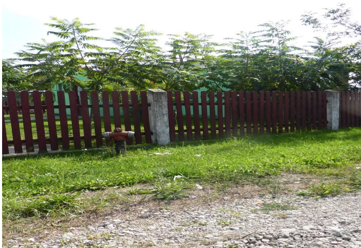
Fot. nr 67. Hydrant w Siecieniu
