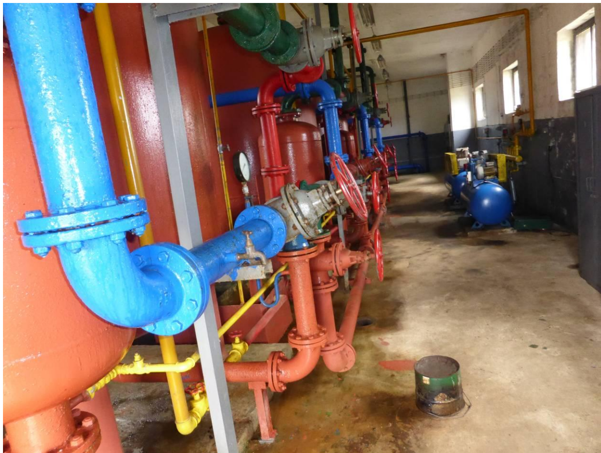
Fot. nr 31. Widok pomieszczenia z urządzeniami technologicznymi stacji uzdatniania wody w Karwosiekach
