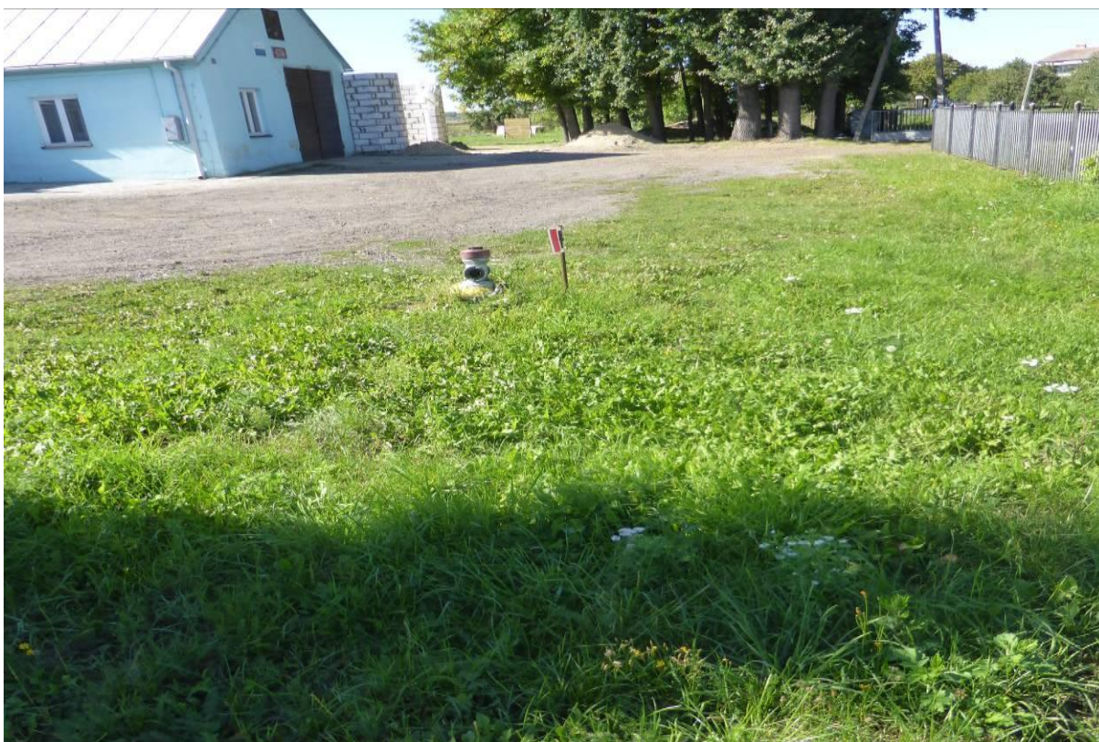
Fot. nr 59. Za nisko obsadzony hydrant w Bądkowie
