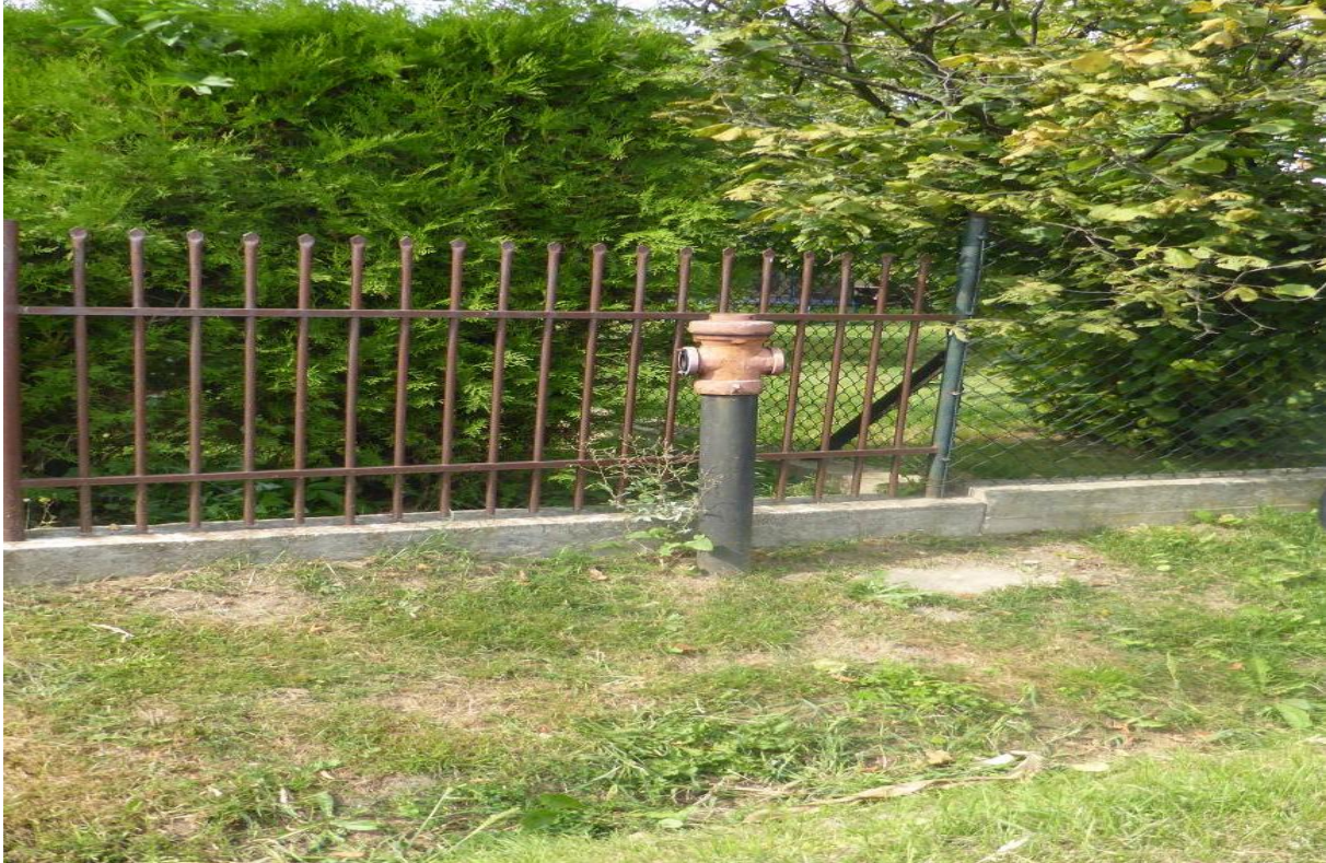
Fot. nr 44. Widok hydrantu ppoż. w Sikorzu
