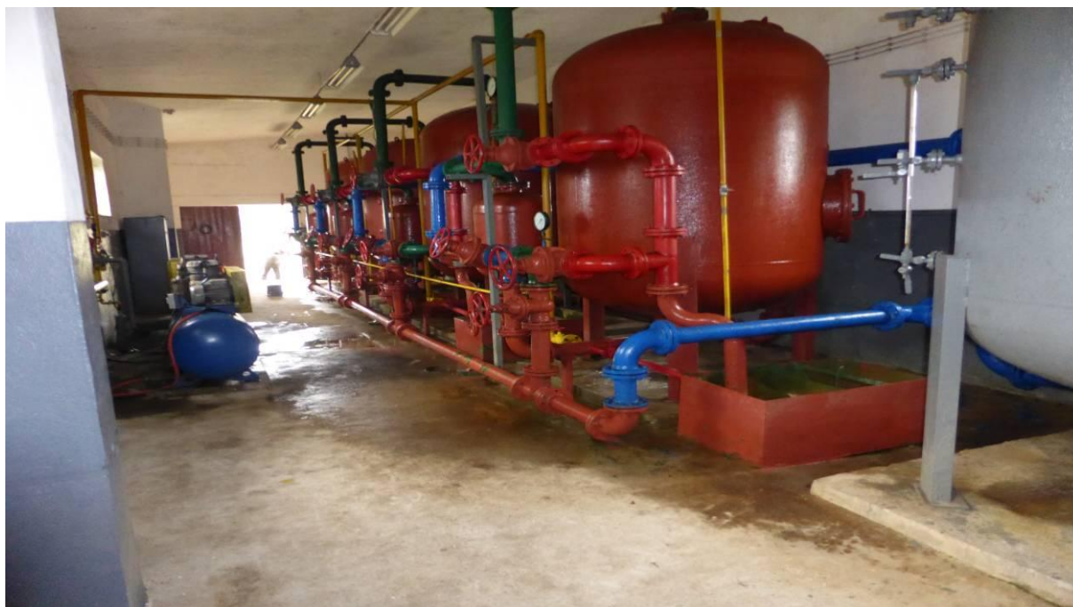
Fot. nr 32. Widok pomieszczenia z urządzeniami technologicznymi stacji uzdatniania wody w Karwosiekach – inne ujęcie
