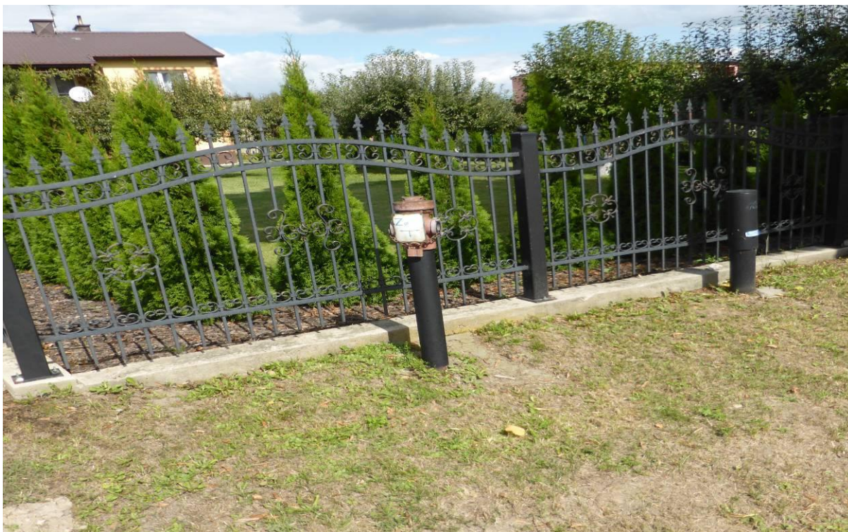
Fot. nr 37. Widok hydrantu ppoż. w Sikorzu przy drodze w kierunku Bielska - uwagę zwraca łańcuch uniemożliwiający szybkie jego wykorzystanie
