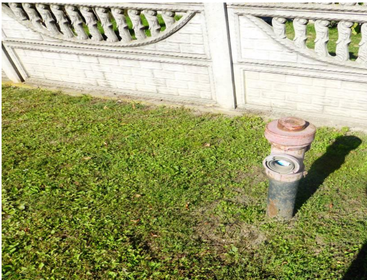
Fot. nr 64. Hydrant w Brudzeniu Dużym
