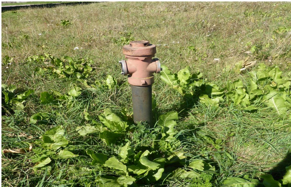
Fot. nr 52. Widok hydrantu ppoż. w Karwosiekach Noskowie - niesprawny
