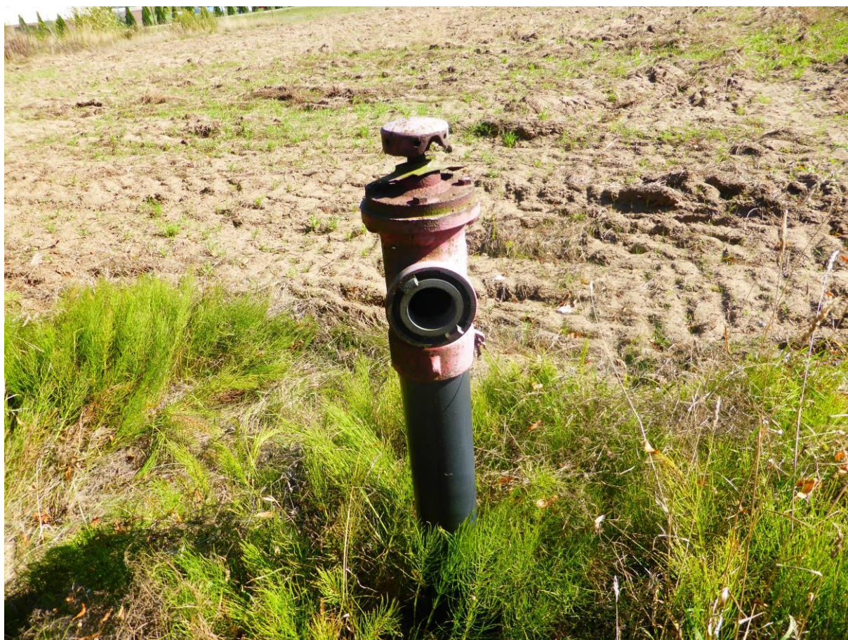
Fot. nr 63. Hydrant w Brudzeniu Dużym
