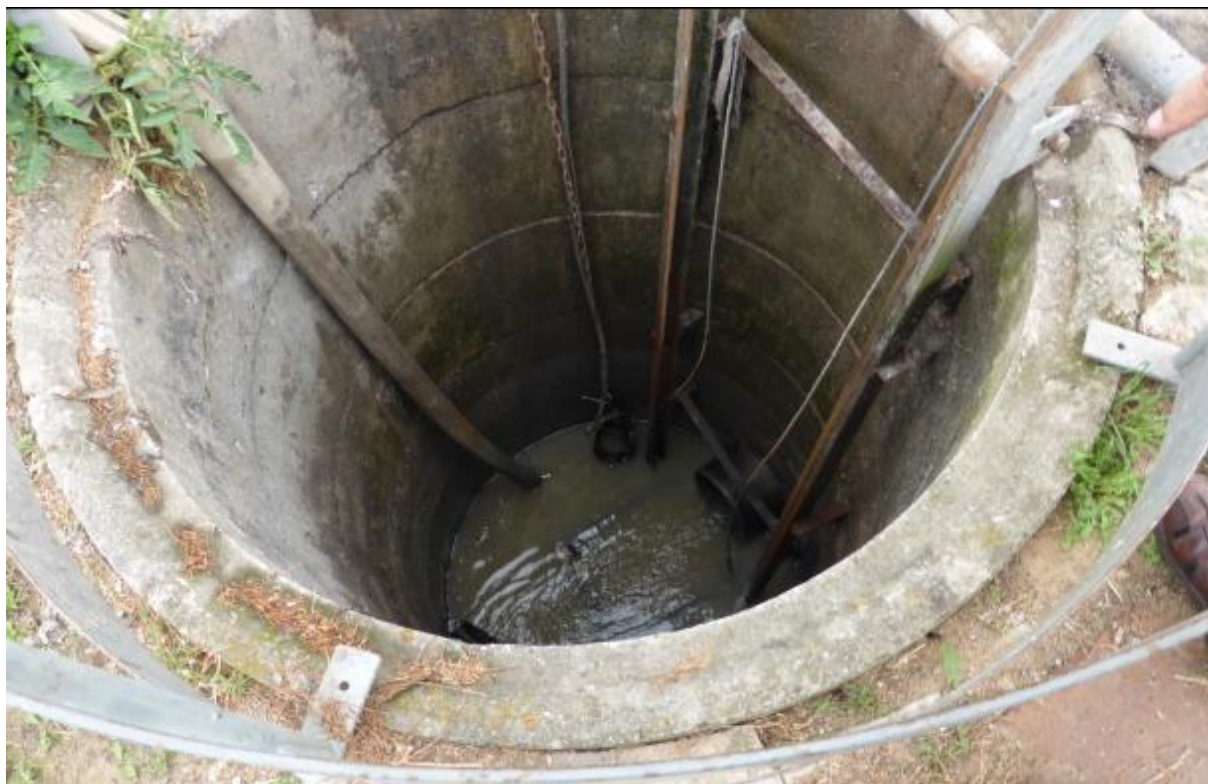
Fot. nr 25. Studnia zbiorcza z kratą i przepompownią w oczyszczalni ścieków w Brudzeniu Dużym
