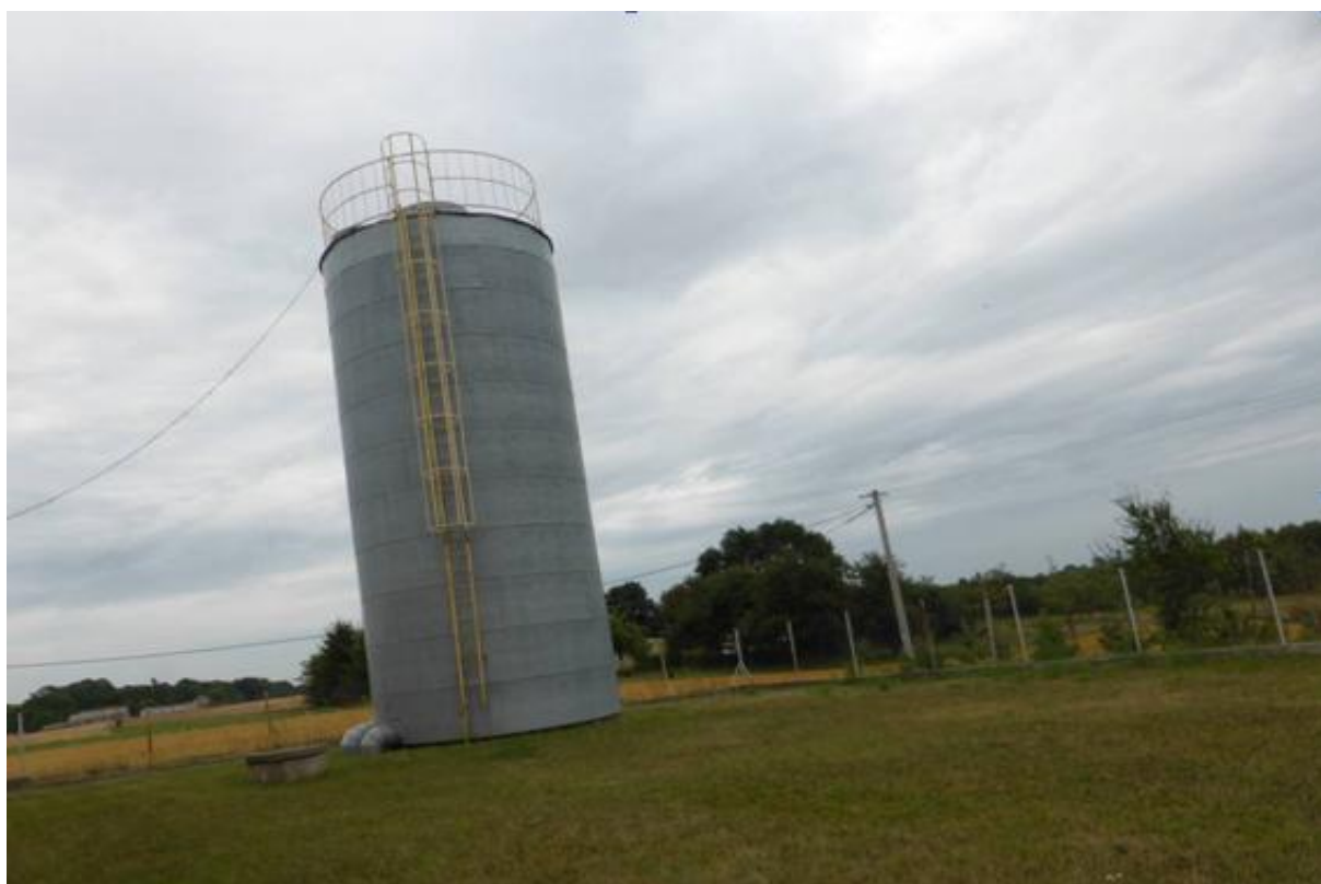
Fot. nr 34. Widok zbiornika wody czystej o pojemności 150 m 3 na stacji uzdatniania wody w Karwosiekach
