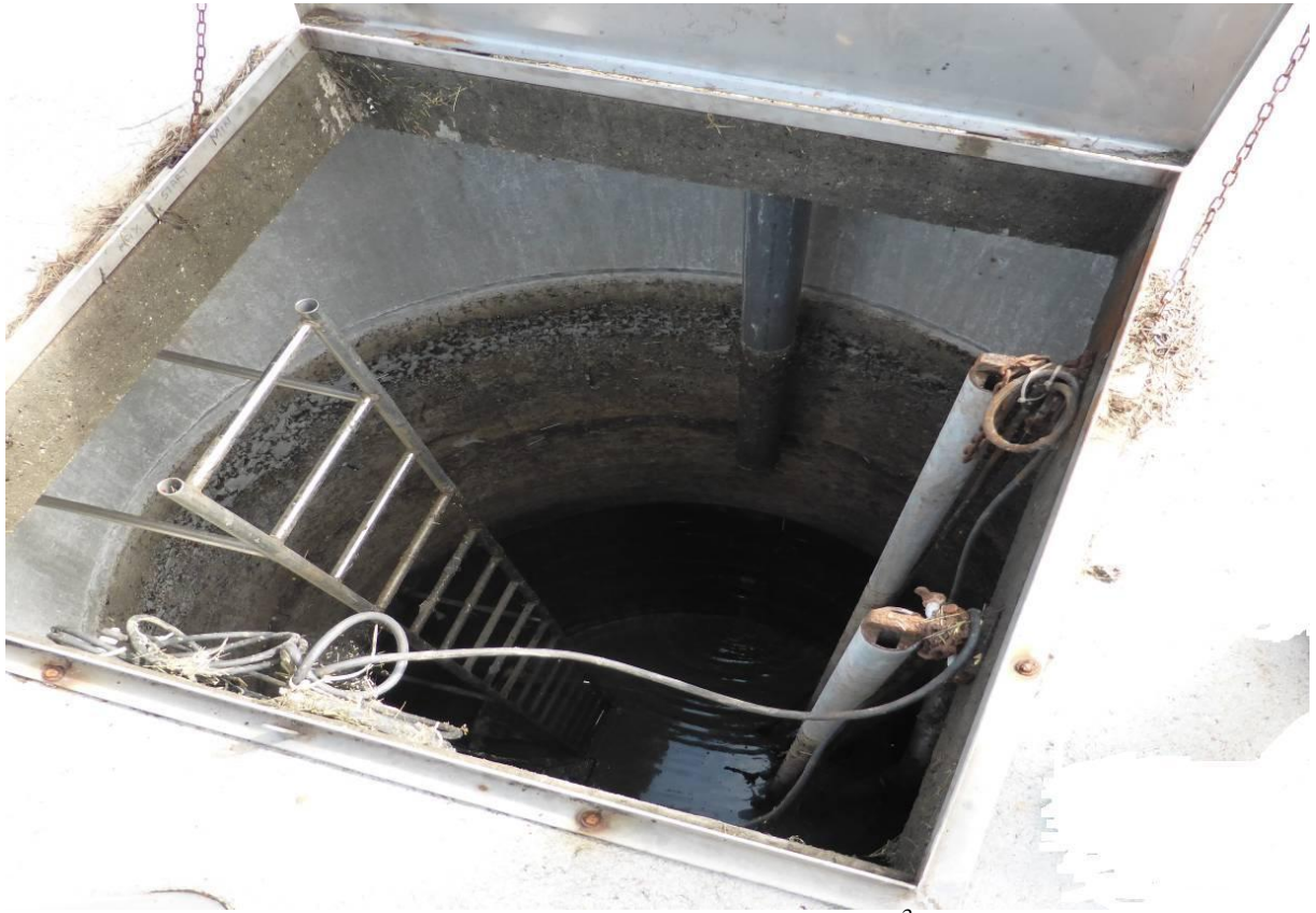
Fot. nr 7. Zbiornik przepompowni o pojemności całkowitej 18 \text{ m}^3 w oczyszczalni ścieków w Siecieniu.
