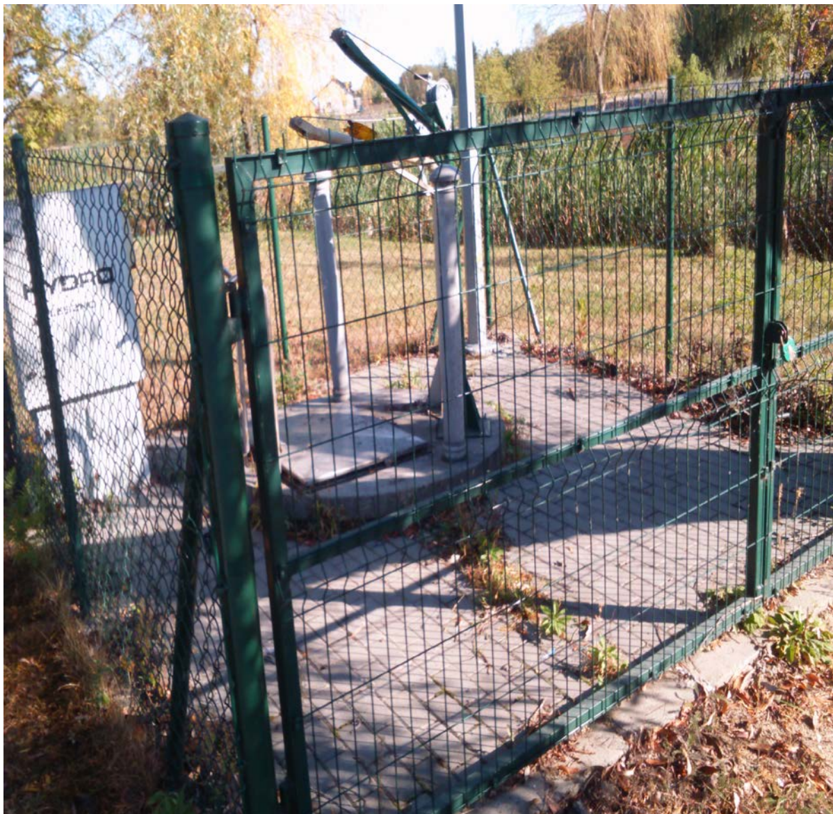
Fot. nr 5. Widok przepompowni ścieków w Siecieniu. Na fotografii widoczny żuraw umożliwiający obsługę przepompowni.
