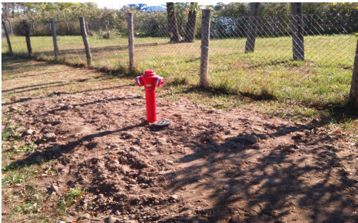
Fot. nr 16. Widok hydrantu wymienionego w ostatnim czasie w miejscowości Siecień
