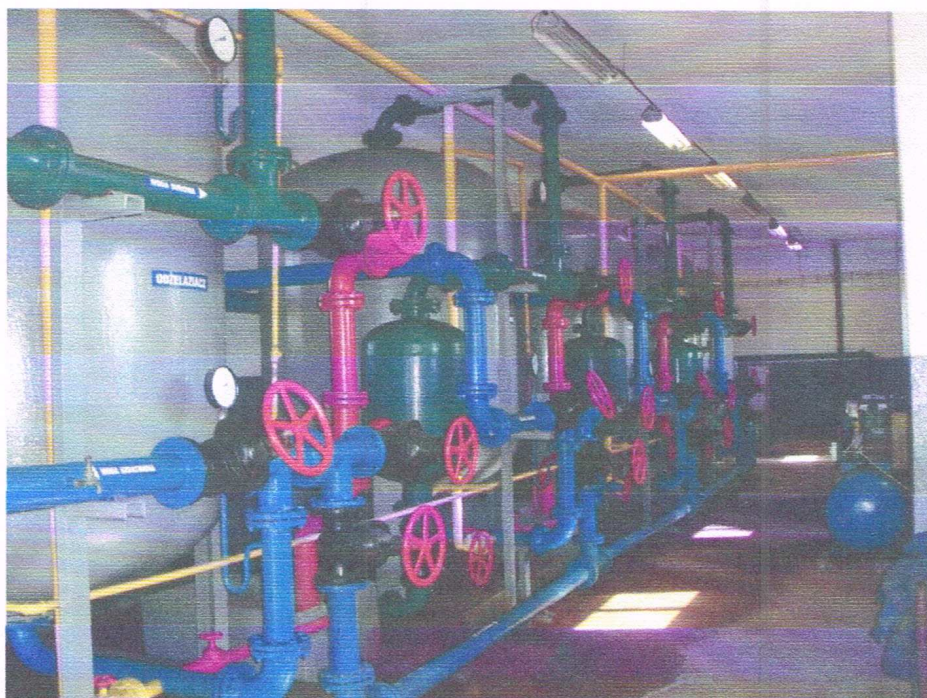
Fot. 1. Armatura znajdująca się w budynku stacji została oczyszczona i pomalowana wraz z oznaczeniem odżelaziaczy i hydroforu.
