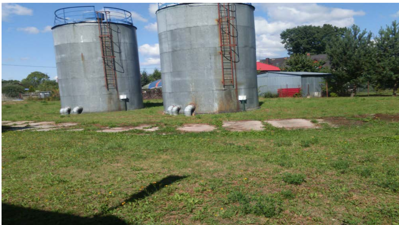
Fot. nr 8. Widok zewnętrznych zbiorników o pojemności 2 \times 80 \text{ m}^3 na stacji uzdatniania wody w Brudzeniu Dużym
