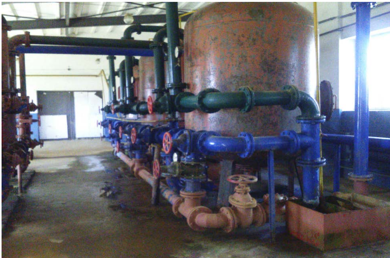
Fot. nr 7. Widok pomieszczenia z urządzeniami technologicznymi stacji uzdatniania wody w Brudzeniu Dużym (widoczne oczyszczone powierzchnie urządzeń)
