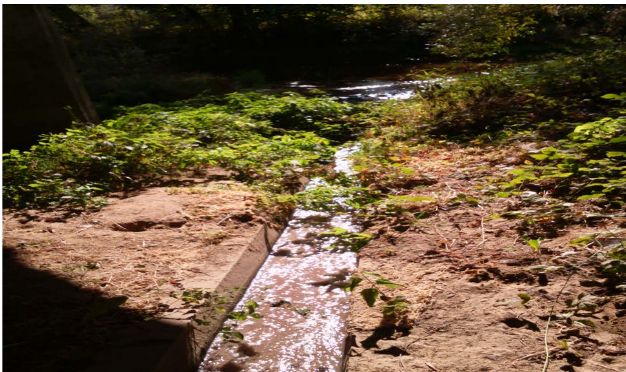
Fot. nr 12. Otwarty kanał betonowy odprowadzającego ścieki z oczyszczalni ścieków w Bądkowie Kościelnym do nurtu rzeki Skrwy Prawej
