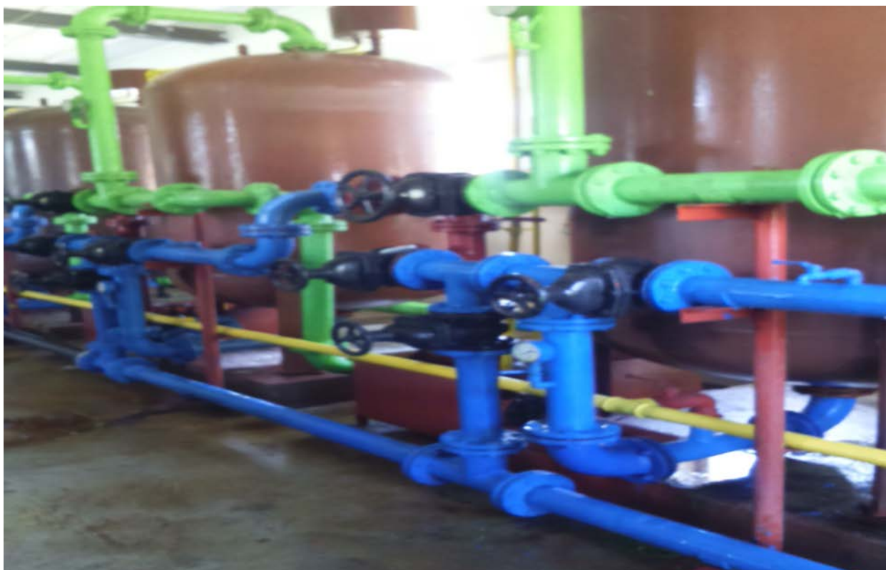
Fot. nr 2. Widok wnętrza stacji uzdatniania wody w Siecieniu
